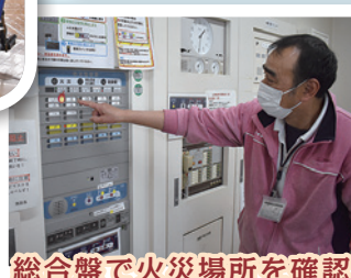
散水栓を使用した 消火活動
